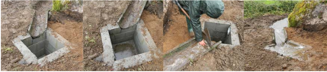
2-03-2013 Filtro por gravidade para retenção de impurezas
